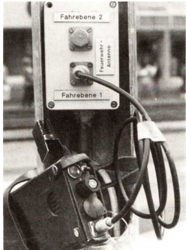
Anschlusspfosten der BF Köln an einem Straßentunnel
